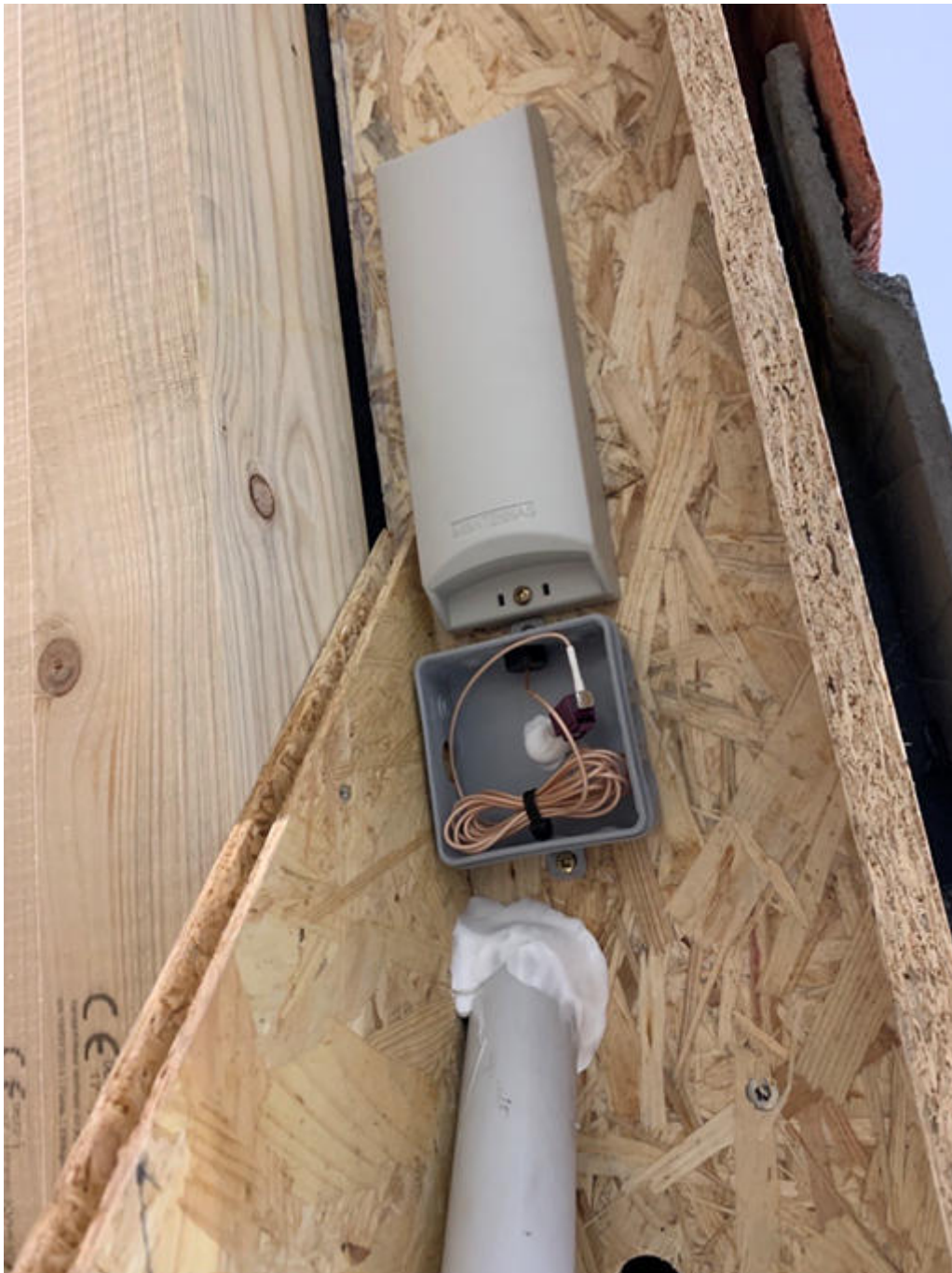
Abbildung 4: Das Antennenkabel ist ordnungsgemäß verlegt, und der Mindestbiegeradius des Kabels wird eingehalten. Der Stecker ist im Installationsgehäuse untergebracht, so dass er vor Witterungseinflüssen geschützt ist.
