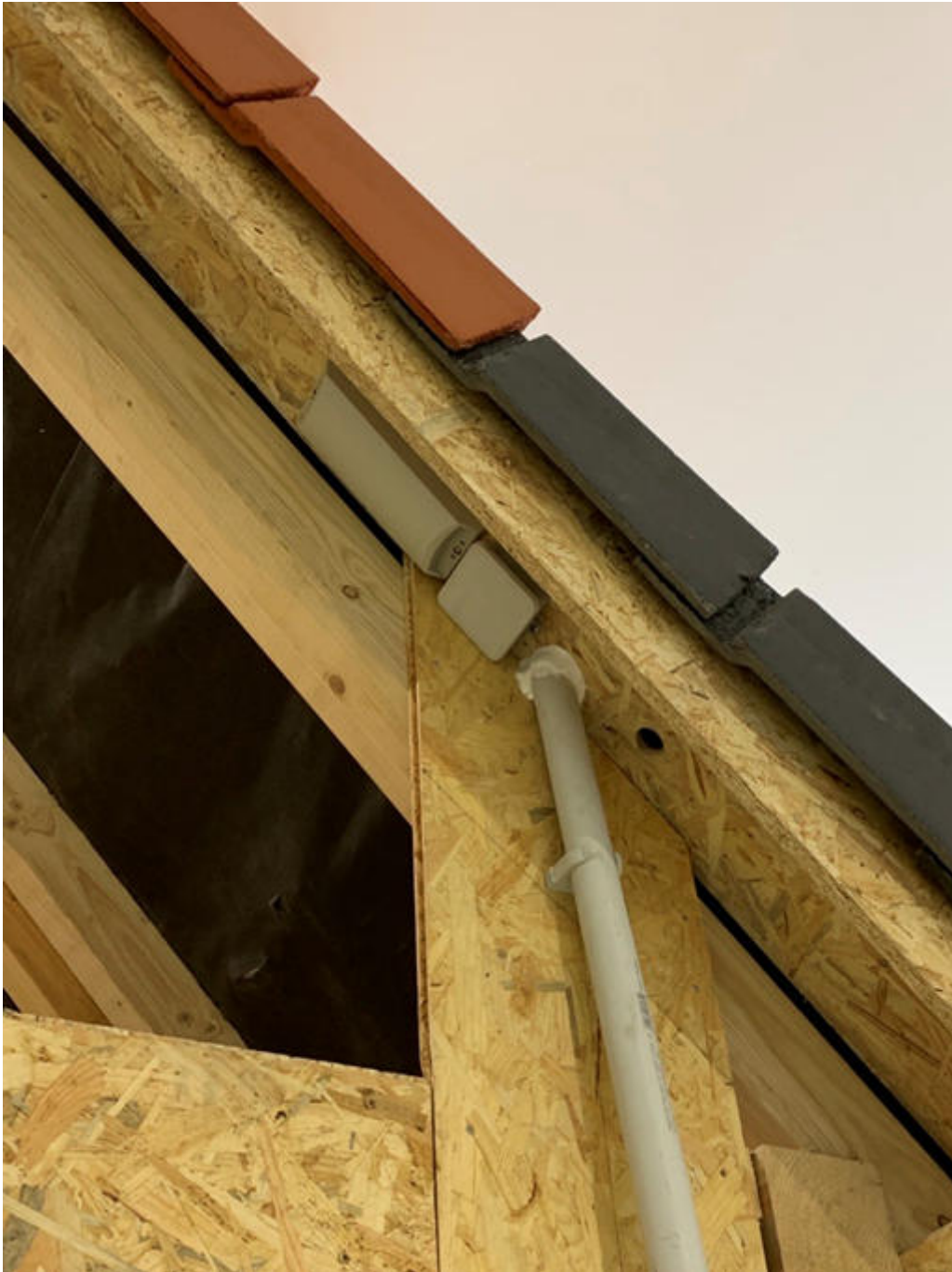
Abbildung 3: Die Antenne wurde direkt unter dem Dach montiert. Die Antenne ist so vor Regen und direkter Sonneneinstrahlung geschützt.
