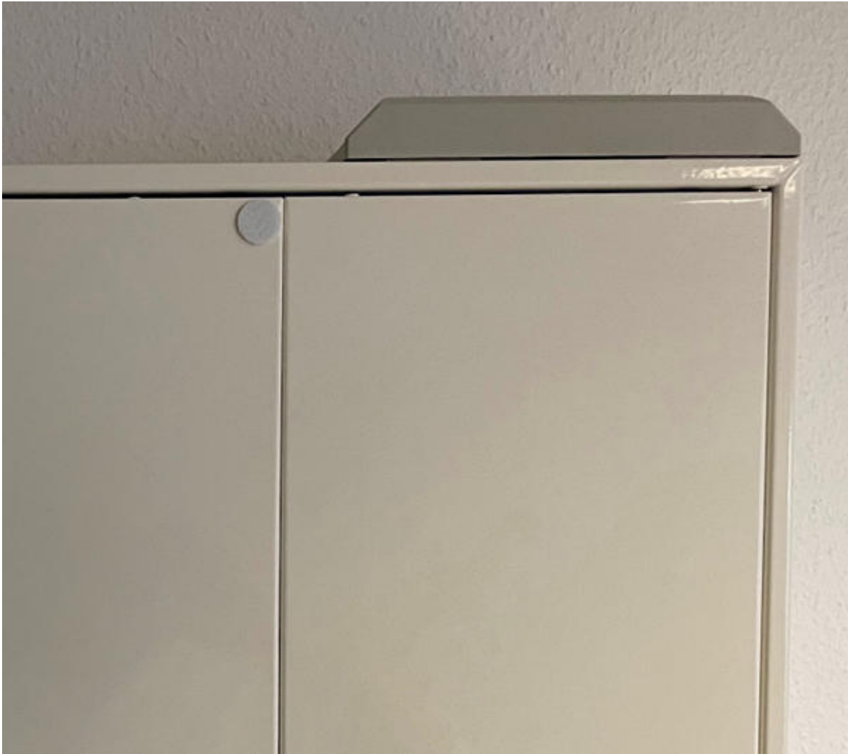
Abbildung 2: Die Antenne wird mit Hilfe der Klebepads von oben auf einen Zählerschrank montiert.
